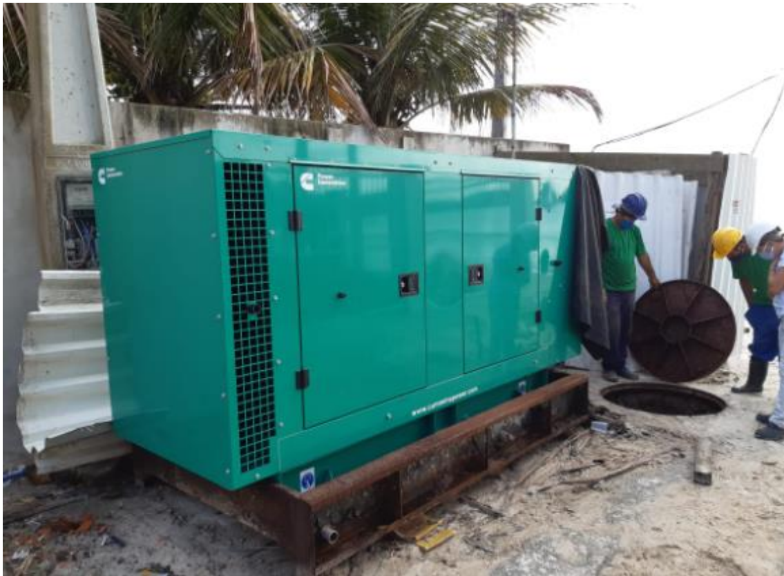
Figura 11: Gerador novo da EE01
